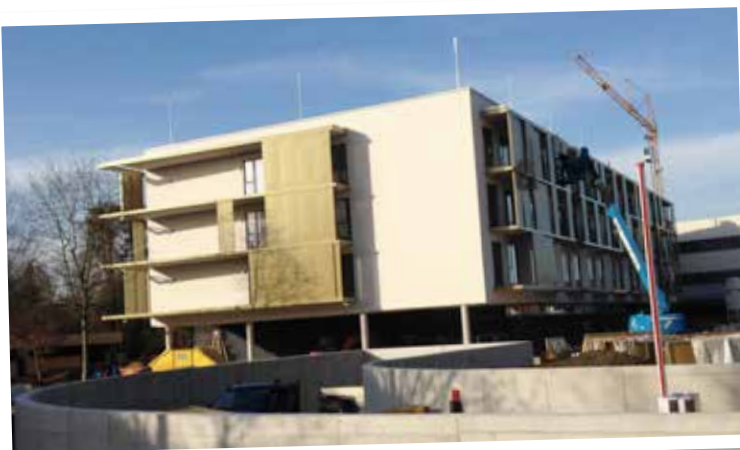
Derzeit gibt es viele große Baustellen in Bad Hall, die allen Verkehrsteilnehmern Geduld abfordern. Vor allem die Franz-Josef-Straße und die Linzerstraße sind davon betroffen. In der Linzerstraße wurden noch alle Leitungen vergraben bzw. neu dimensioniert, damit einer Voll-Sanierung im Frühjahr nichts mehr im Wege steht.
